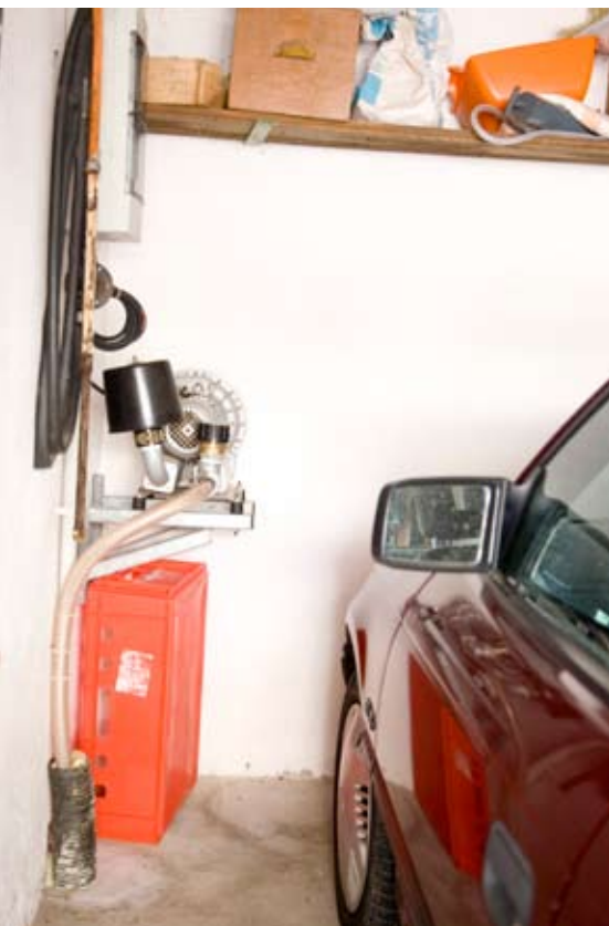
Die Anlagensteuerung wurde in der Garage installiert.
