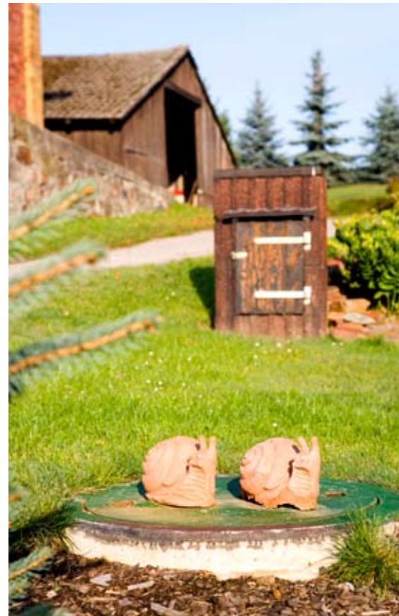
Die Anlage passt sich perfekt in die bestehende Gartengestaltung ein.
