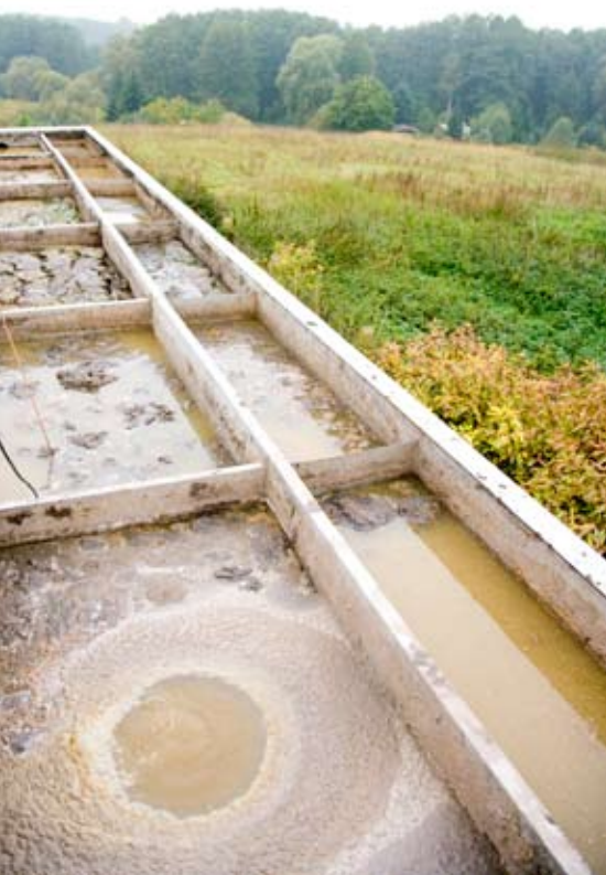
Blick auf die Klärstufen der Abwasseraufbreitungsanlage.
