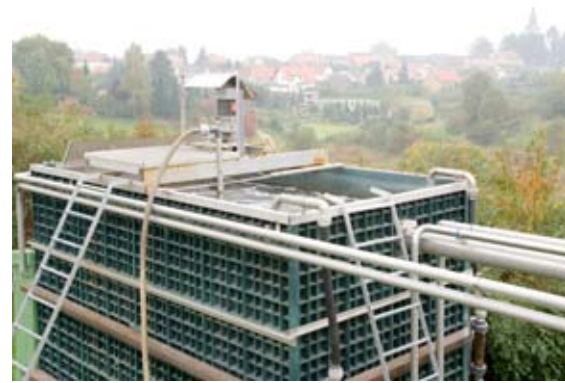
Der Denitrifikationsbehälter mit WSB® clean Reinigungsleistung.
