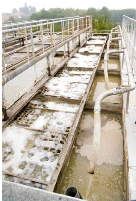
Klärstufen der Biesenthaler Abwasseraufbereitungsanlage.
