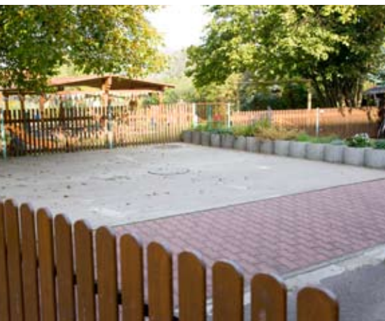
Die Kläranlage ist im Innenhof versteckt und nur noch an den Kanaldeckeln erkennbar.
